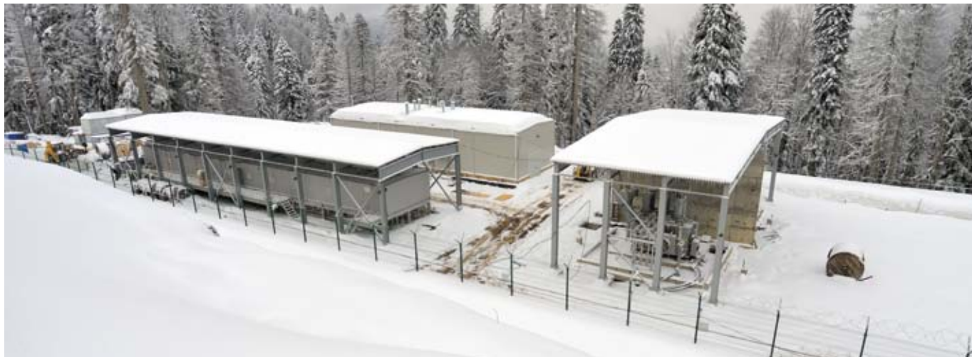
Панорамный вид подстанции 110/10 кВ на площадке «Псехако»
