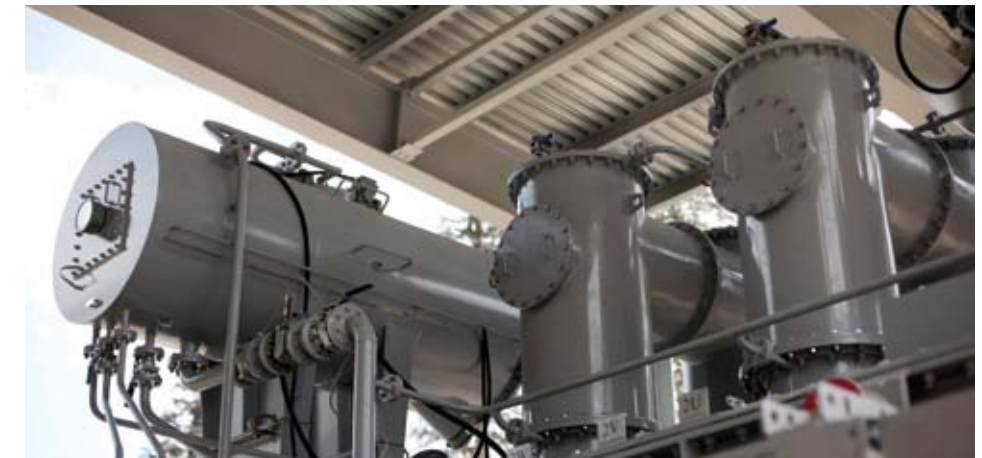
Силовые трансформаторы 110/10 кВ мощностью 25 МВА ПС «Псехако»
