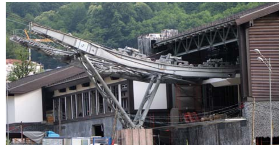
Станция канатных дорог ГКК «Альпика-Сервис», пос. Красная Поляна
